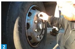
2 Dokud je autobus ještě na zemi, je třeba povolit všechny kolové matice.
